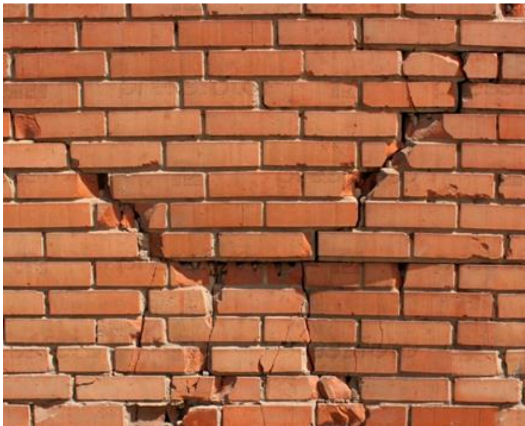
Рисунок 19. Множественные силовые трещины кирпичной кладки
