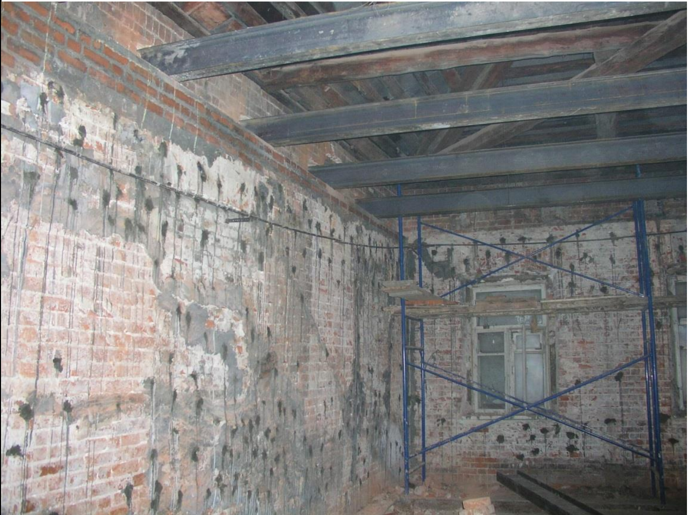
Рисунок 22. Инъекция раствора в кладку с множественными трещинами с целью повышения ее монолитности и расчетного сопротивления сжатию
